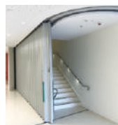
Horizontal sliding fire door (ODC)
